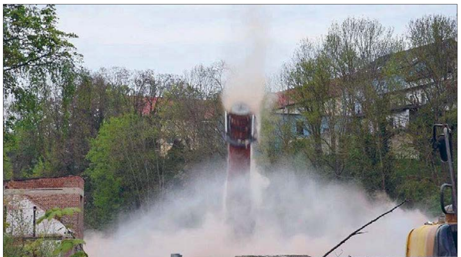
Fallender Schornstein. Sicht aus der Färberstraße, Foto: Chr. Rinck
