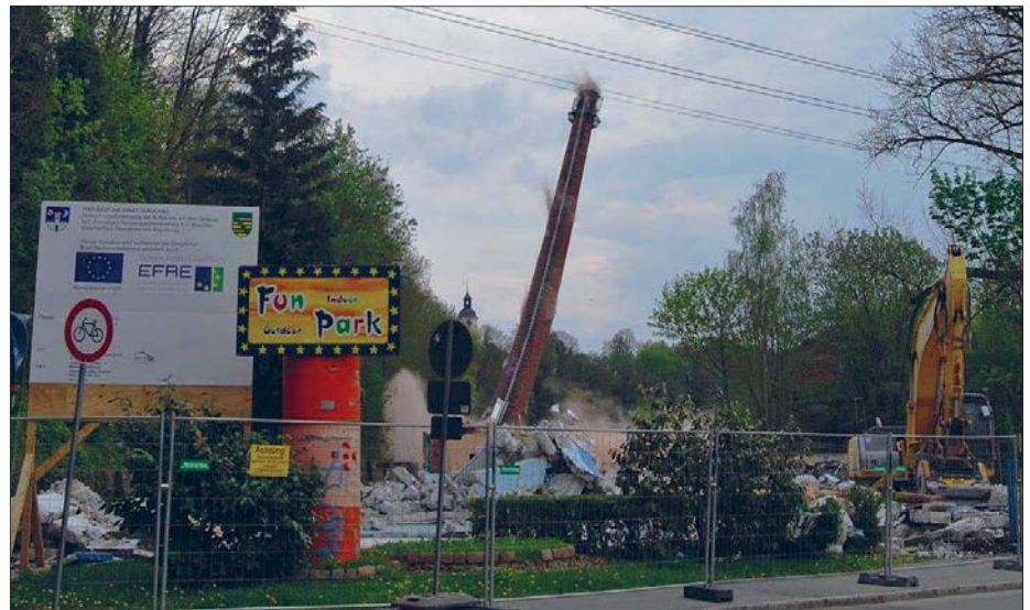
Der Schornstein kippt. Sicht aus der Mühlgrabenstraße/Ecke Wehrdigtstraße, Fotos (3): Stadt Glauchau
